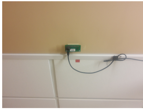
(d) Sensor pod mounted on ceiling
